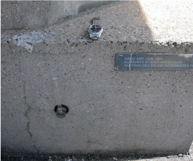
Abb. 7: w -Wert Messung mit dem Karstenschen Prüfröhrchen. Vor allem im unteren Bereich der Säule gab es viele Abplatzungen (z. B. an der Kante links oben), die vorwiegend wegen der früheren Parkplatzsituation entstanden sind.
