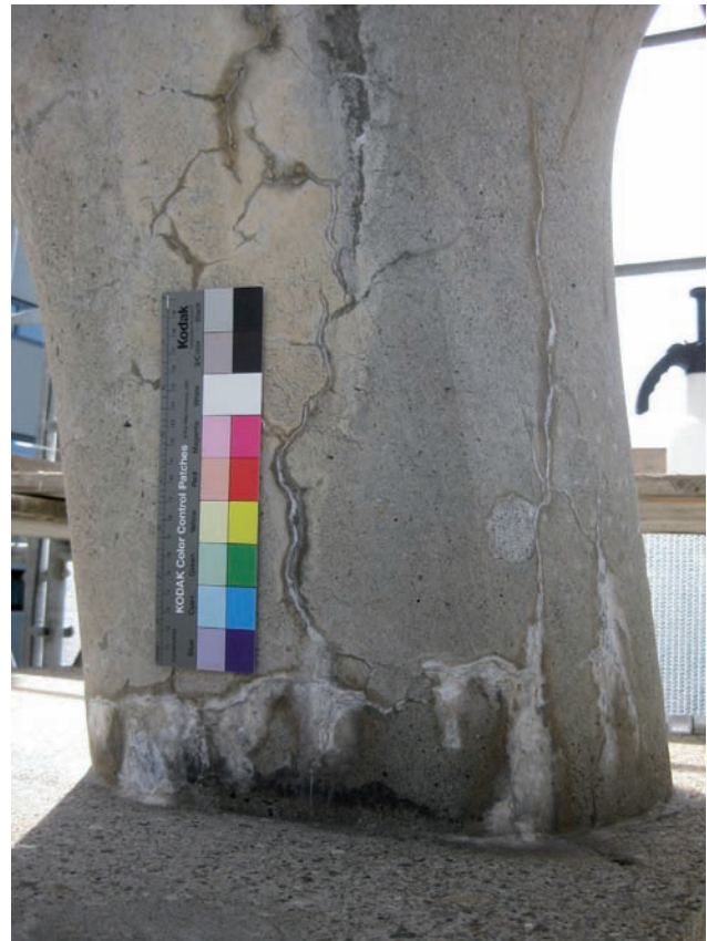
Abb. 5: Typisches Bild einer ablaufenden Alkali-Kieselsäure-Reaktion AKR: Charakteristische Risse, weiße Ausblühungen und Aussinterungen sowie Abplatzungen.
