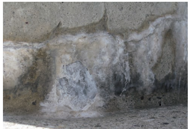
Abb. 6: Detail der Krusten und Ausblühungen aus Abb. 5.
