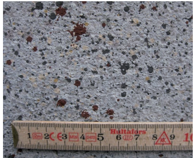
Abb. 11: Eine andere Strategie und Zielvorgabe an der umgebenden Architektur. Kulissenmalerische Kleckse und Farbspritzer als Betonimitation im Stile des „Pointillismus“. Ein angepasster Ersatzmörtel wie in Abb. 9 gezeigt, hätte eine solche, nicht nachhaltige Massnahme nicht nötig.
